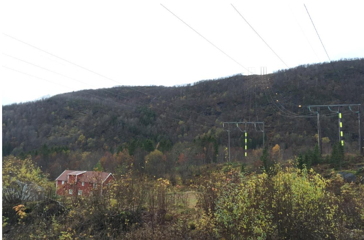
Figur 4: Ut fra Hopen transformatorstasjon vil ny ledning gå i eksisterende trasé. Fra den venstre mast i bildet vinkler ledningen til venstre i bildet og går på skrå opp lia.
