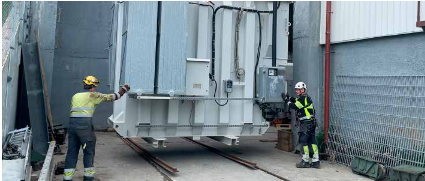
↑ Pent brukt trafo settes på plass på Charlottenlund i Tromsø
